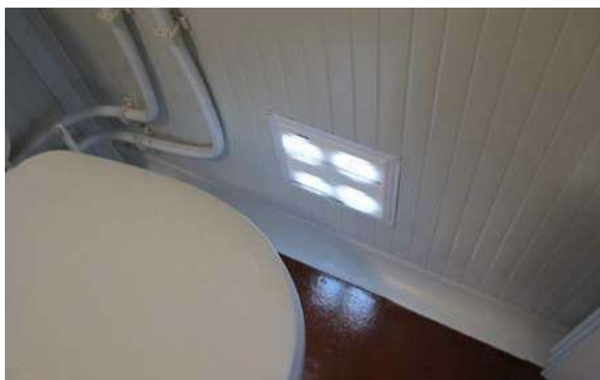
Fig. 3.3.06 ► Ventilación en aseo.
