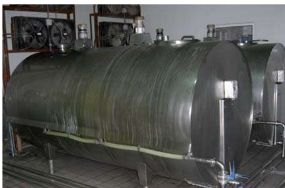
Imagen 6.2. Tanque de enfriamiento y tanque de almacenamiento de leche.
