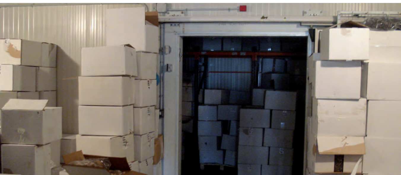
Cámara de congelación de producto final
