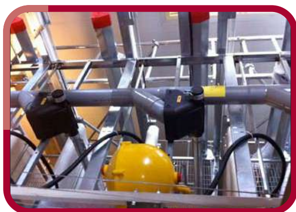
Sistema de distribución de agua a los bebederos de la nave.
