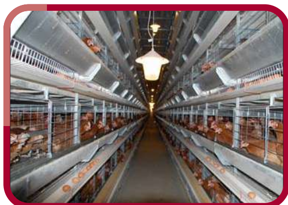
Sistema de iluminación en nave en jaulas con puntos a varias alturas.
