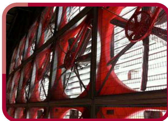
Ventiladores de una nave vistos desde el interior.
