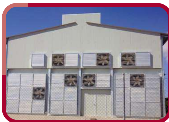
Cabecera de nave con sistema de ventilación tipo túnel
