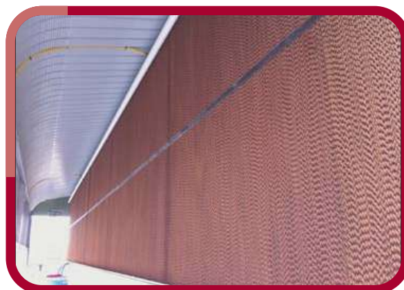
Paneles de refrigeración.
